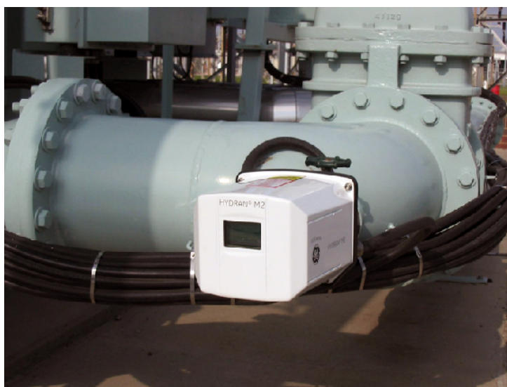
سنسور نصب شده روی ترانسفورماتور
